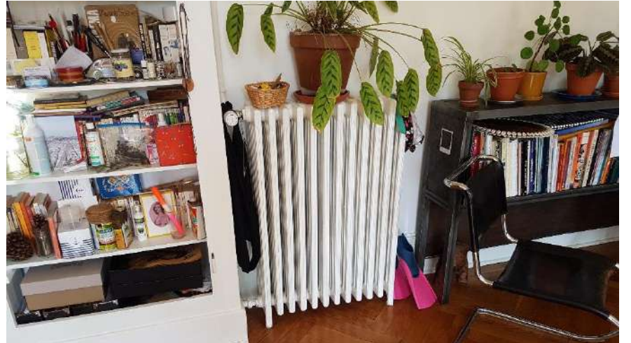
Corps de chauffe
