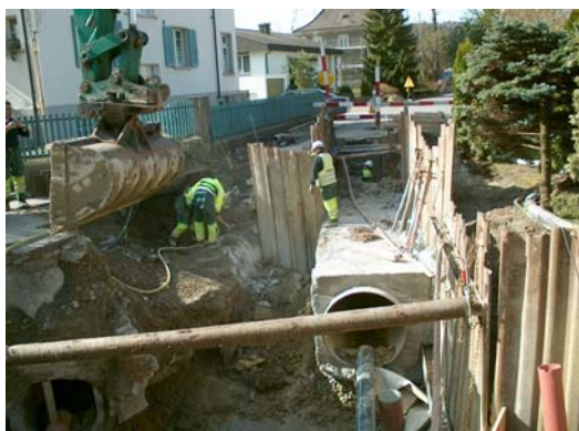
Kanalisations- und Büttikerbachleitungen
