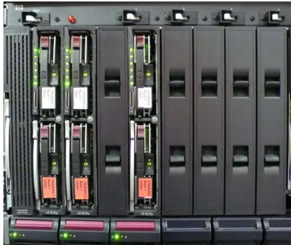
Blade-System der Gemeinde Wohlen mit 3 Servern
