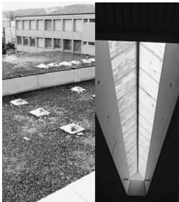
Schäden Schulhaus Junkholz
