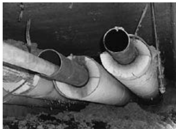
Alte verrostete Fernleitungen
