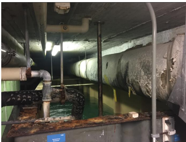
Beckenwasserausgleichsbecken aus dem Jahre 1966
