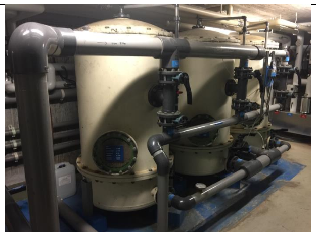
Filteranlage aus dem Jahre 1966
