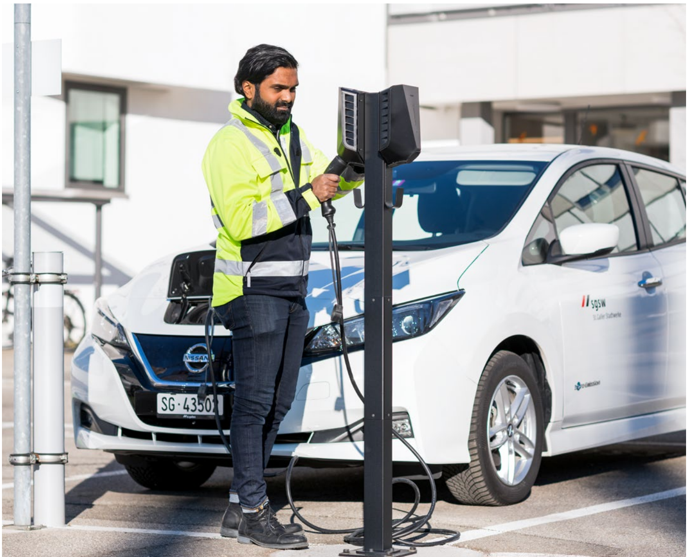
↑ Machleish Santhiyapillai, Projektleiter Mobilität, testet eine E-Ladestation an der Fürstenlandstrasse in St.Gallen.
