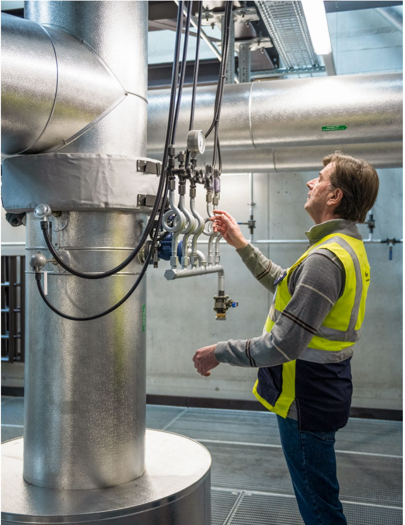
↑ Michael Stang, Gesamtprojektleiter Fernwärmeausbau, prüft den Kesseldruck in der neuen Fernwärmezentrale Lukasmühle.
