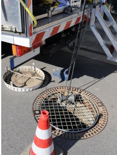
Installation für Kanal-TV Aufnahmen
